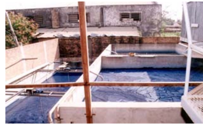
Estação de tratamento de efluentes
