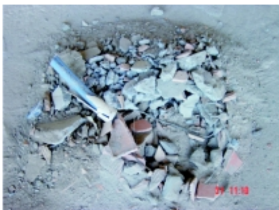
Figura 25- Lixo varrido no chão da obra
