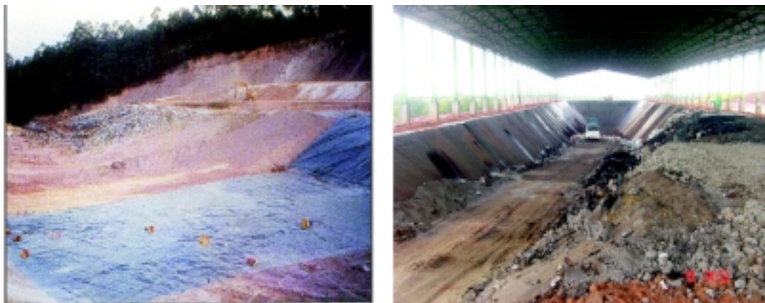
Figura 36 - Células de destinação final de resíduos
