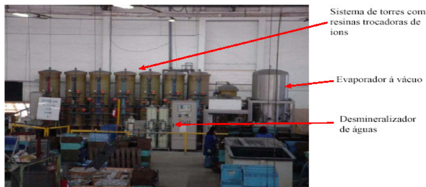
Figura 24 - Sistemas de tratamento de águas de recirculação por resinas de troca iônica e evaporador a vácuo
