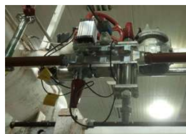
Figura 2 – Adequação da válvula NH3
